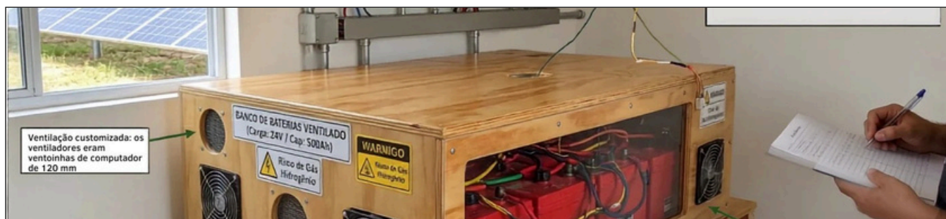
Banco de baterias com ventilação customizada e monitorização de temperatura e SOC, num sistema fotovoltaico documentado pelo Brevemito.
